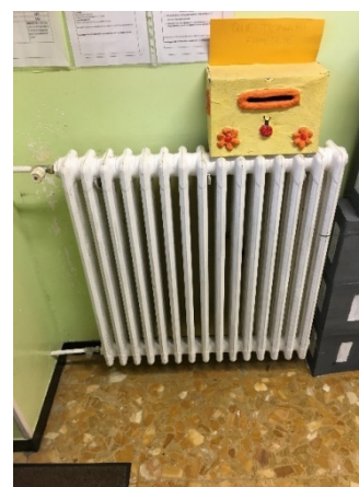
Figura 4.6 - Particolare corpi scaldanti - termosifoni
