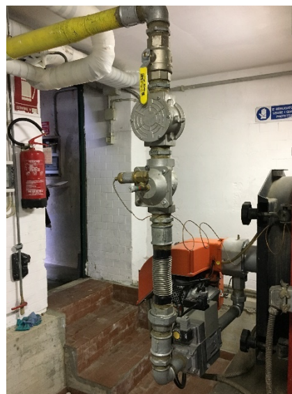
Figura 4.9 - Generatore di calore – ECOFLAM -ECOMAX 33 2F – BRUCIATORE BALTUR
