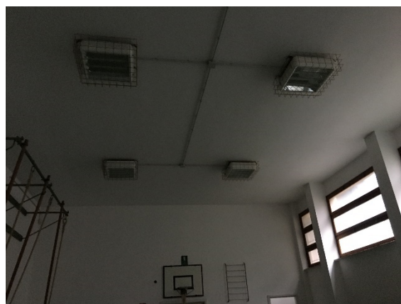
Figura 4.11 - Particolare dei corpi illuminanti
